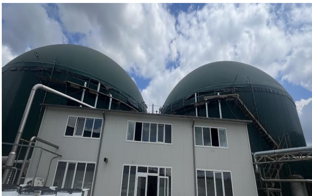
Figura 5.1 Imaginea foto a digestoarelor cu funcționare continuă a întreprinderii SRL „Garma Grup”
