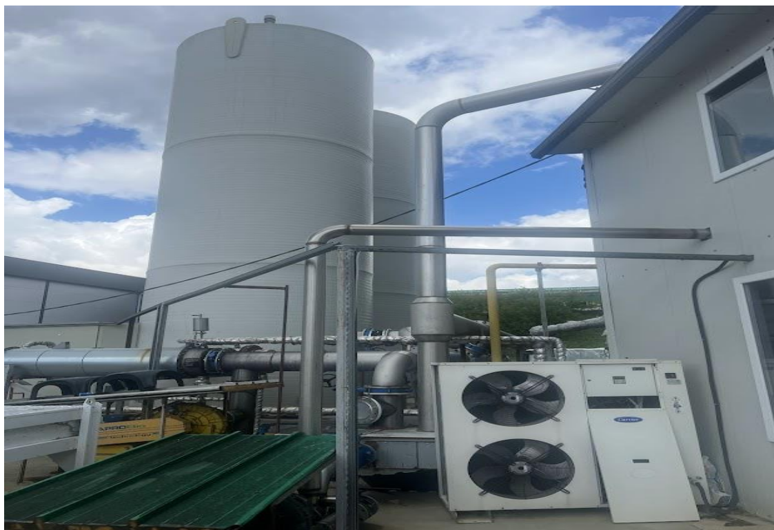
Figura 5.5 Instalația de purificare a biogazului din cadrul întreprinderii SRL „Garma Grup”
