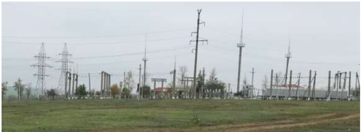
Fig. 2.4. Stația de transformatoare din orașul Ceadâr-Lunga studiată
