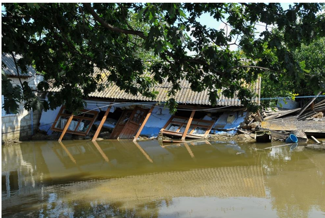
Fig. 4.20. O casă distrusă de inundații, s. Nemțeni, r-nul Hâncești, 6 iulie 2010 sursa: agora.md
